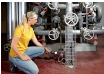
1 Prüfung des Schutzleiters
