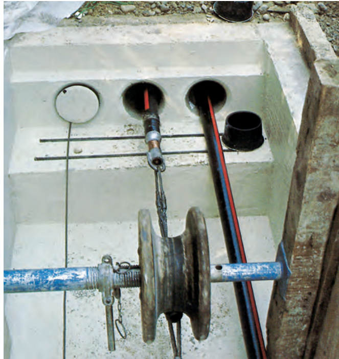
Kunststoffrohanlage mit Muffenschacht.
