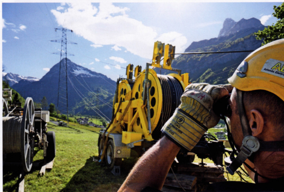
Kontrollierter Ablauf: Damit das Nylonseil nicht zu schnell von der Seiltrommel läuft, benutzt Norberto Stucchi ein Holzbrett als Bremse (oben). Dieselbe Aufgabe übernimmt beim Einziehen der Leiterseile die Bremsmotorrolle (unten). Chefmonteure Heiri Rhyner überprüft mit dem Feldstecher, ob die Leiterseile ausreichend gespannt sind
